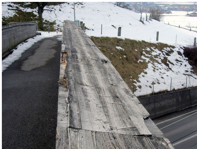
Fußgängerbrücke vor der Sanierung 1
