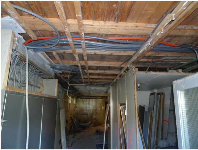
Decke vor der Ertüchtigung
