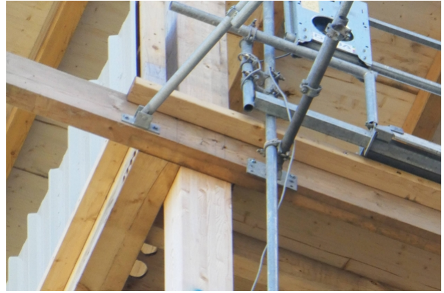
Brandschutz Riegel pro Etage
