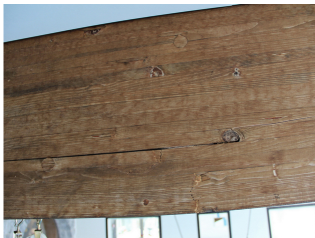
Défaillance des poutres en bois lamellé-collé
