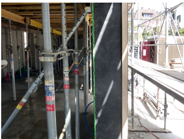
Parois porteuses en bois CE avant le bétonnage de la dalle CE
