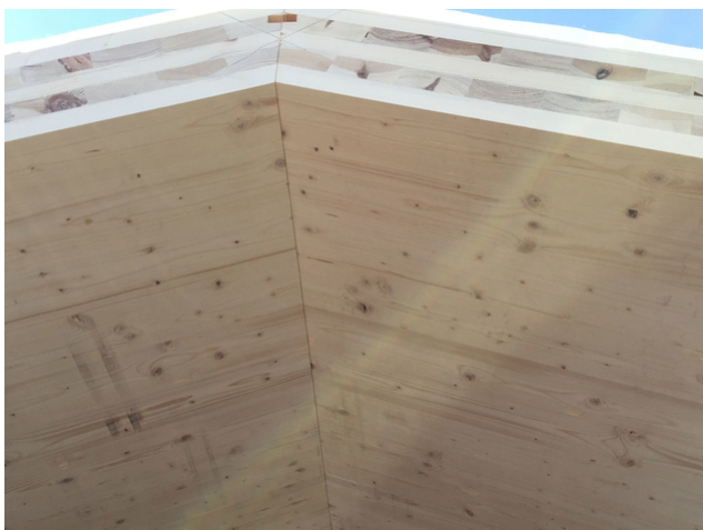
Instantané des travaux de construction : Assemblage des panneaux de toiture au niveau du faîte
